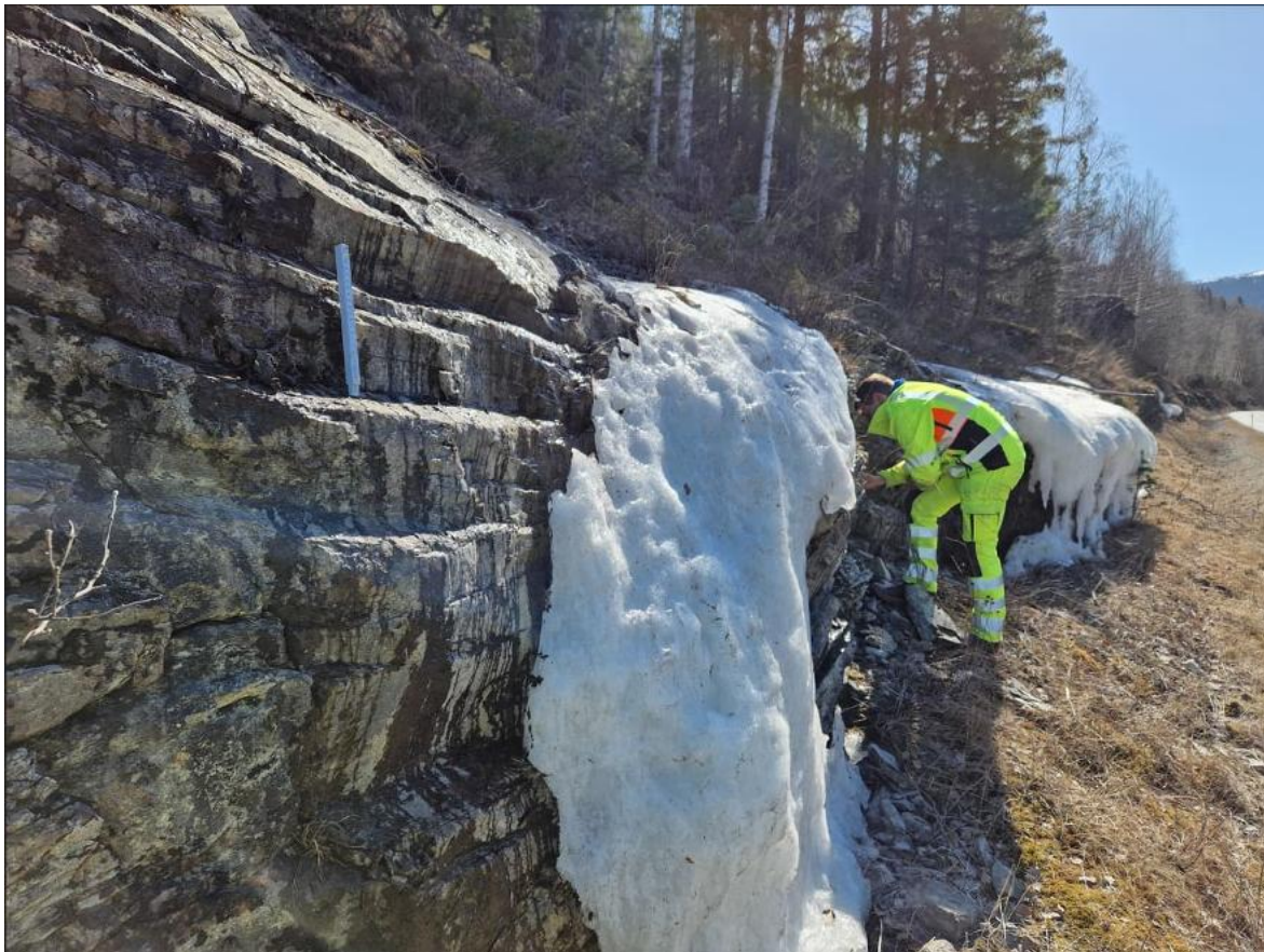
Figur 7-2: Tegn på at det forekommer isdannelse i eksisterende skjæring langs E6. Bilde tatt ved befaring i april ved ca. profil 2700.
