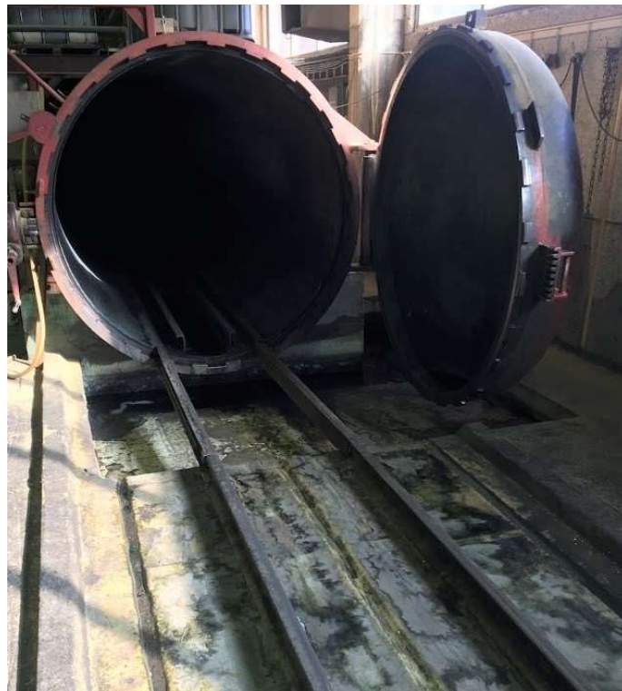
Bilde 1: Trykktank og skinnesystem med drypparrangement.
