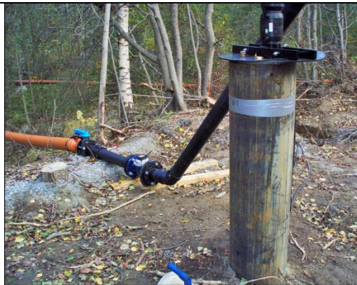
Figur 6. Eksisterende B1 ved Thoøya. Føringrør i kant med brønnrør.
