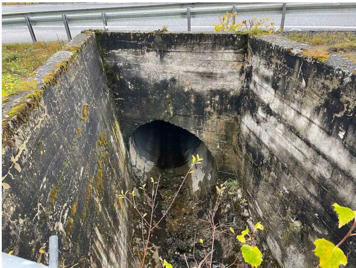
Figur 8: Sirkulært rør under E6.
